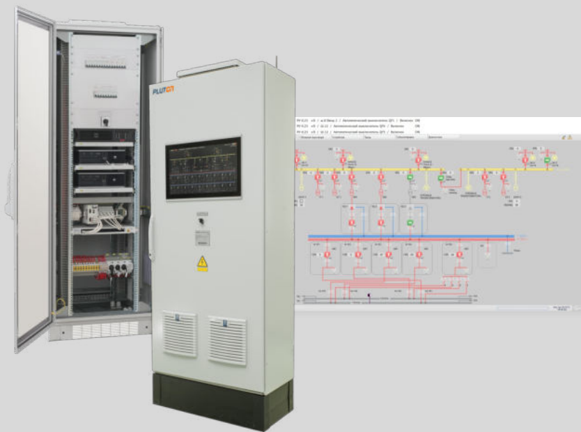
Рівень 2. керування підстанцією
