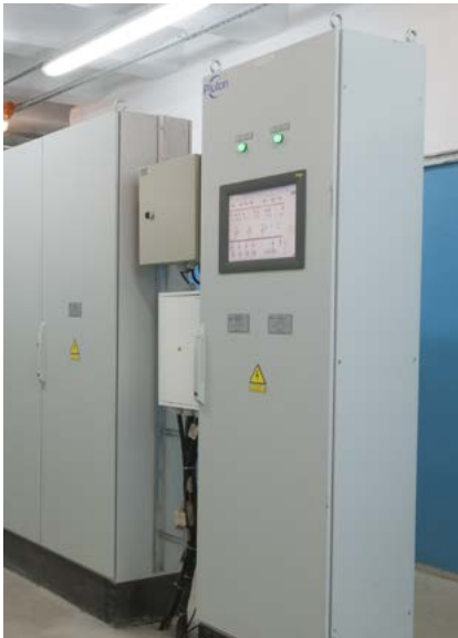
▲ Нова шафа телемеханіки підстанції
