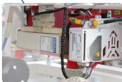
▲ Установка пристрою тестування лінії (випробувача коротких замикань ВКЗ)
