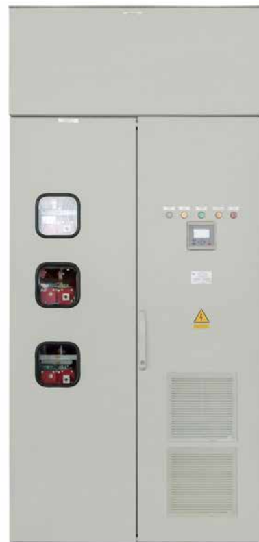
▲ Преобразовательная секция рекуператора
