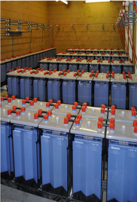
▲ Рис 3. Аккумуляторные батареи в Екатеринбургском метрополитене, ст. “Чкаловская”
