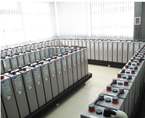
▲ Рис 4. Аккумуляторные батареи в Бакинском метрополитене, ст. “Азадлыг Проспекти”
