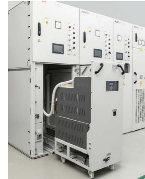
Сверхбыстродействующий бездуговой выключатель AFB (подстанция Kontshallen)
