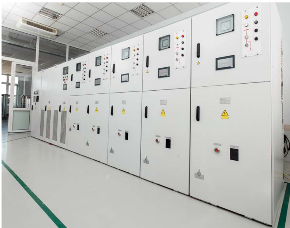
Рис. 5. Внешний вид оборудования тяговой подстанции
