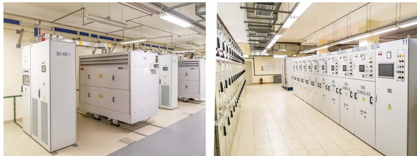
Рис. 1. Тяговая подстанция производства компании «Плутон» (ст. «Юбилейная площадь»)
